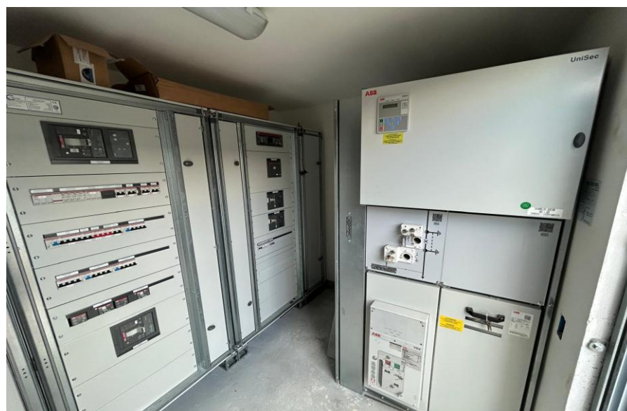
Cabina elettrica MT/BT
