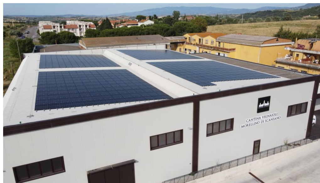
Impianto FTV e tetto industriale
