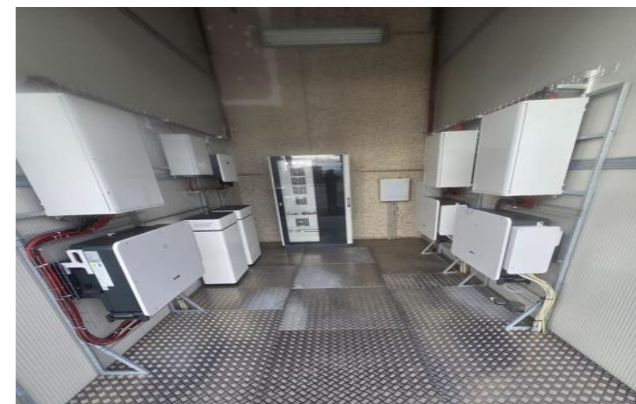
Locale tecnico impianto FTV
