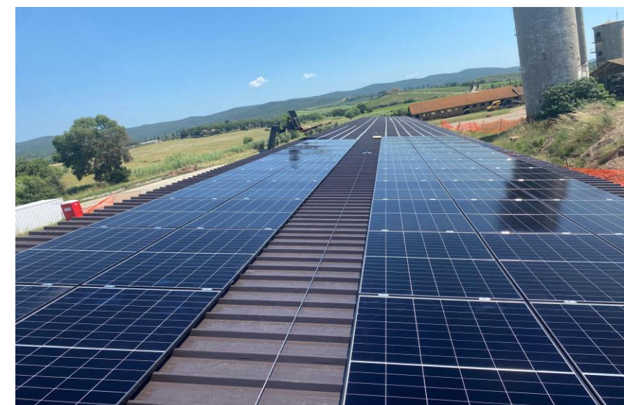
Pensilina fotovoltaica industriale
